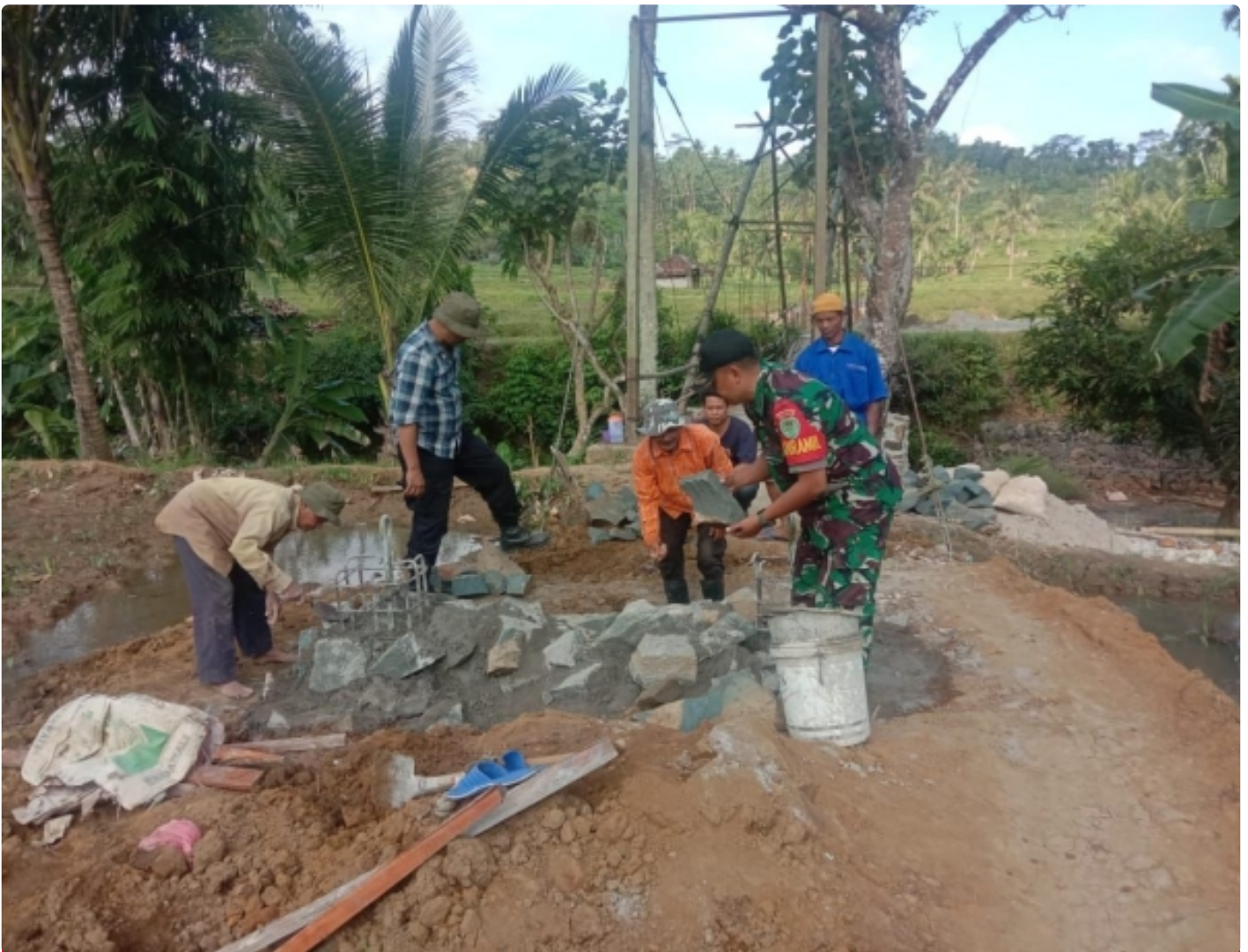
Kpt Arm Witono Bersama Para Babinsa dan Warga Gotong Royong Bangun Jembatan Gantung
