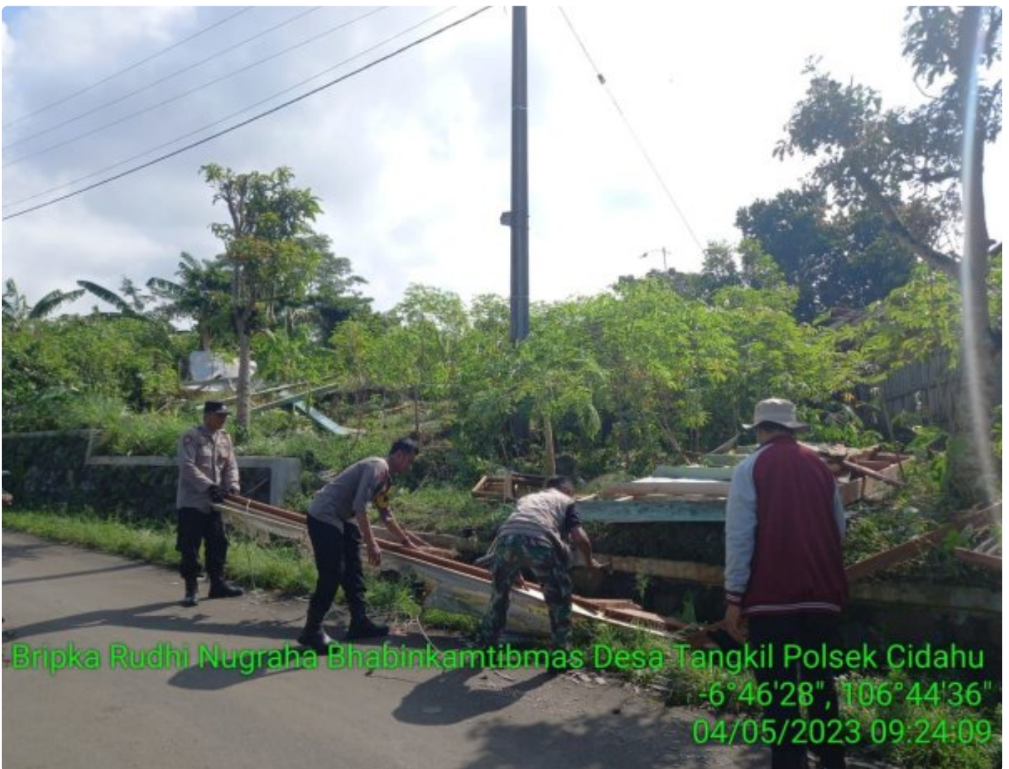
Tim Gabungan Tni Polri dan Forkopimcam Evakuasi Rumah Roboh Akibat Angin Puting Beliung
